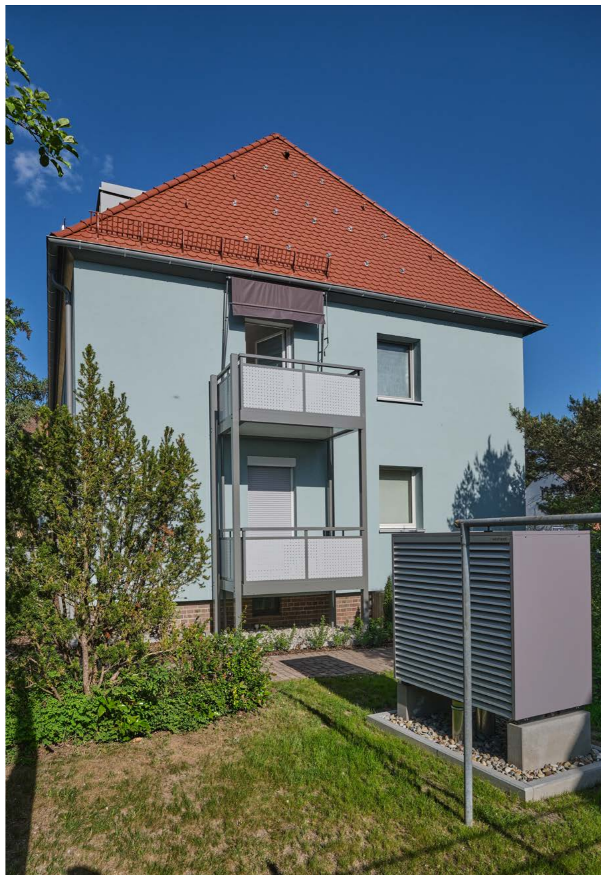
Hiltmannsdorfer Straße 76a – Standort Wärmepumpe
